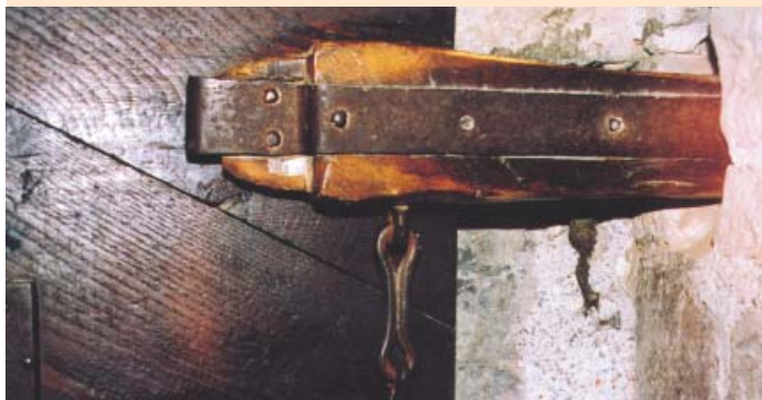
Eglise Abbatiale de St-Bertrand de Comminges (Hte Garonne). Détail d'une barre et fermeture, d'origine. Remarquons l'usure très importante du bois, l'extrémité ferrée et la pendeloque du morailon assurant la fermeture.
