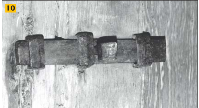
10 Châteauneuf en Auxois (Côte d'Or) - Verrou plat fermant une porte intérieure (XV e )
