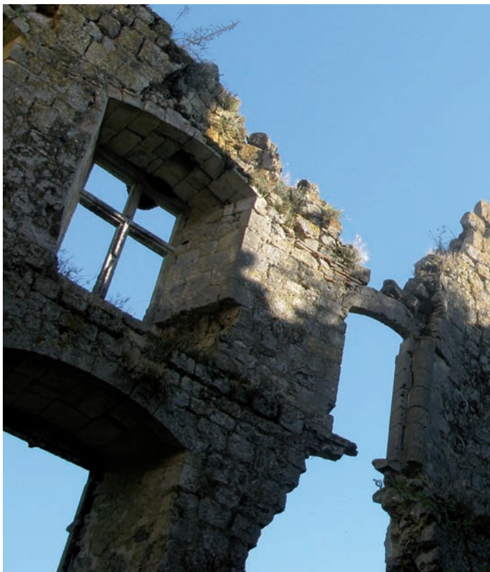
La porte du 2 e étage, qui ouvrait sur l'escalier, est suspendue au-dessus du vide.
